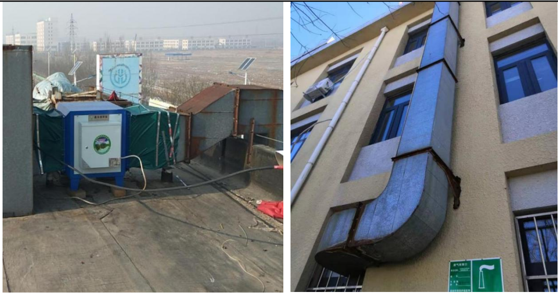
图 8 食堂油烟净化器及排气筒
