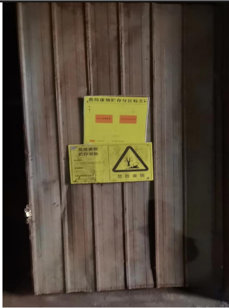
危废暂存间标识
