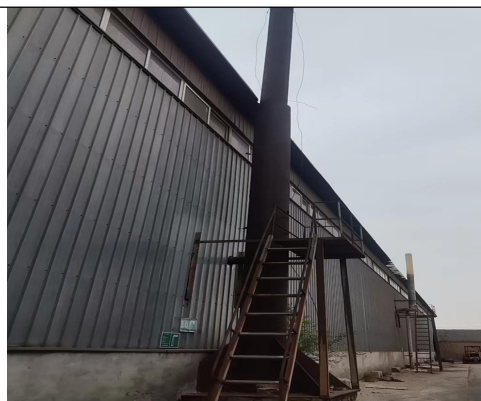
废气排放标识及采样平台
